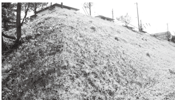
大規模に盛土造成された宅地の急斜面
