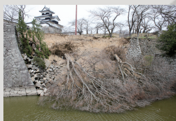
崩落した石垣上部の樹木
