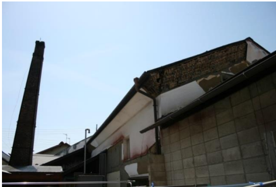
損傷が激しい蔵
