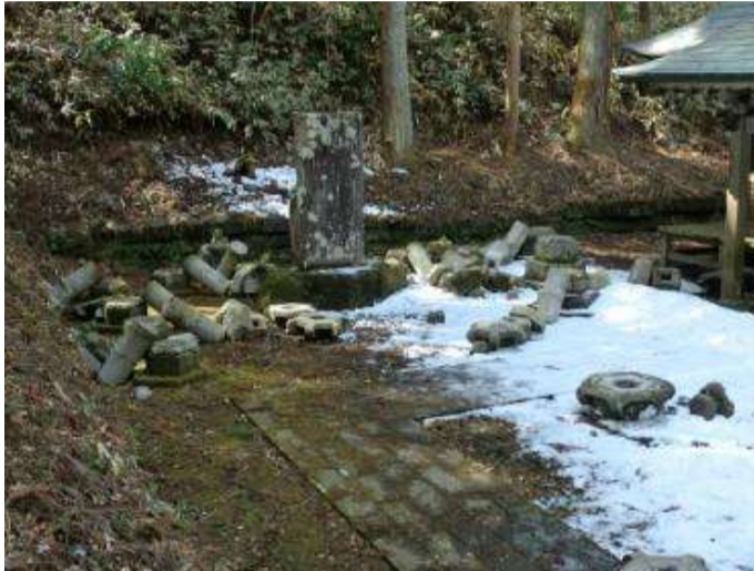
東日本大震災後(平成23年3月14日撮影)
