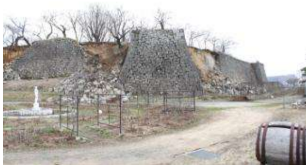
本丸北側の石垣崩落状況
