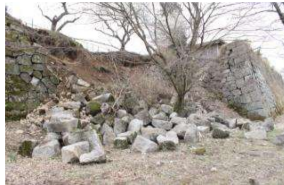
帯曲輪北側の石垣崩落状況
