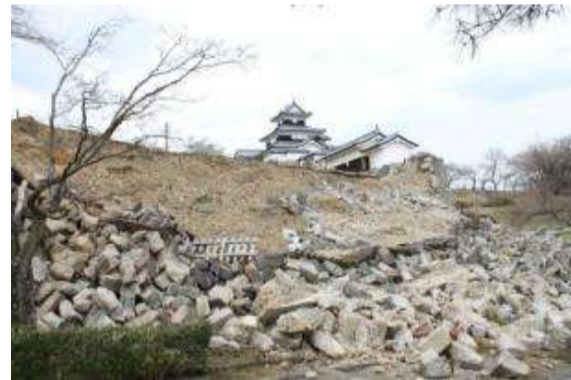
震災により崩落した石垣(本丸南面)
