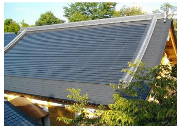
○屋根一体型のソーラーパネル
