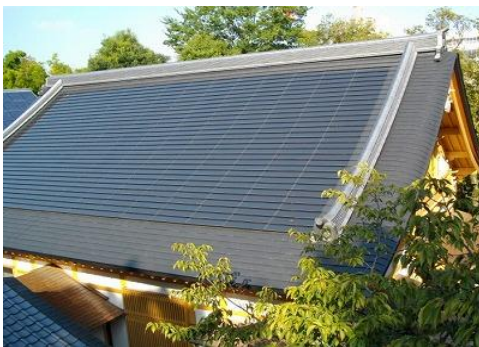
○屋根一体型のソーラーパネル
