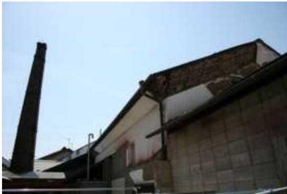
損傷が激しい蔵
