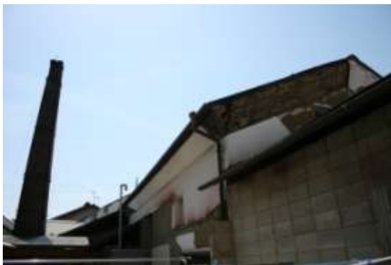
損傷が激しい蔵
